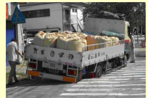
下水管きよに起因した道路陥没
