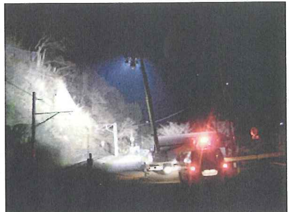
JR 大系線の被災箇所（小谷村）に派遣中の照明車（11 月 23 日）
