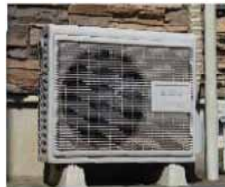
空気熱源ヒートポンプ
