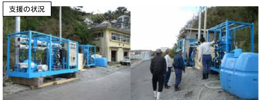
海水淡水化装置設置状況
