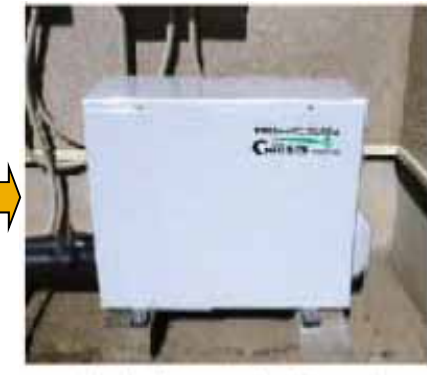
地下水熱ヒートポンプ
