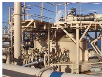
配管継手部等の漏洩対策
