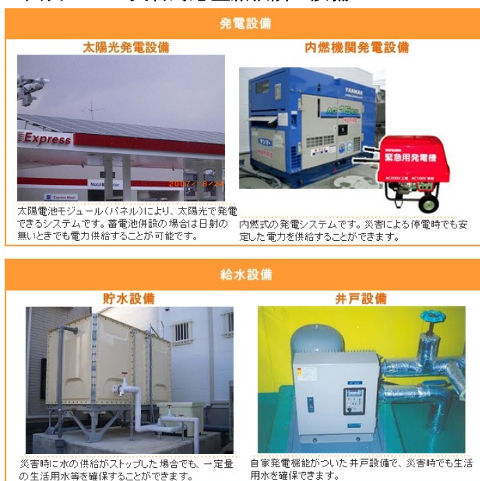
図表 2-25 災害対応型給油所の設備
