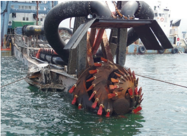
海底地盤を掘削するカッターヘッド。ここで採用されている方式は海水の濁りを抑える方法の一つ
