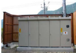
非常用発電機
