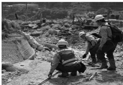
二次災害を防止するための被害状況調査
