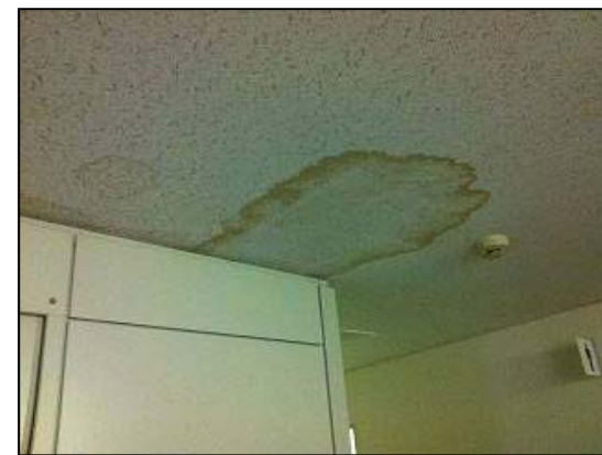
廊下部分：漏水のあと有り。天井裏の配管からの漏れかと思われる。
