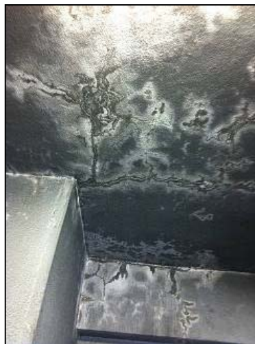
EV機械室 : 漏水及びコンクリートの腐食有り
