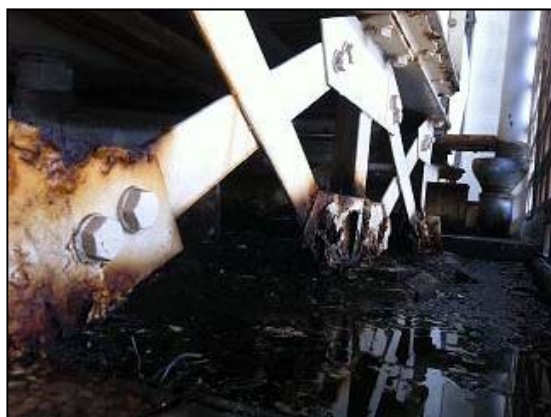
屋上高置水槽基礎：ガセット及びボルトの腐食有り
