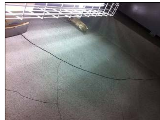
書庫内 : ダクト開口部分から柱へ向けて大きなクラック有り
