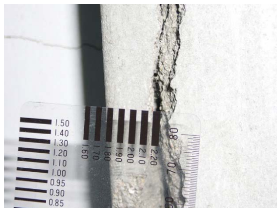
庁舎：内壁のひび割れ状況
