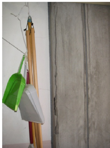
庁舎：内壁にひび割れが見られ、鉄筋が露出している
