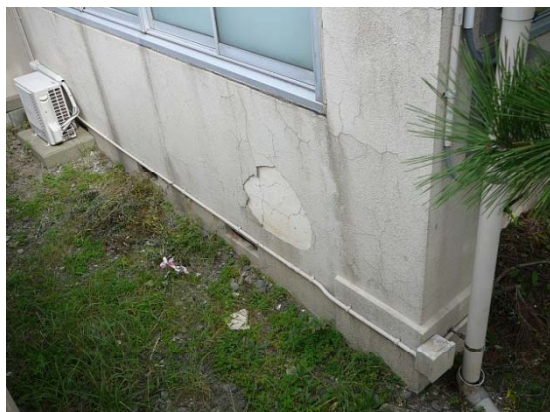
庁舎：外壁にひび割れ、仕上に浮きが見られる
