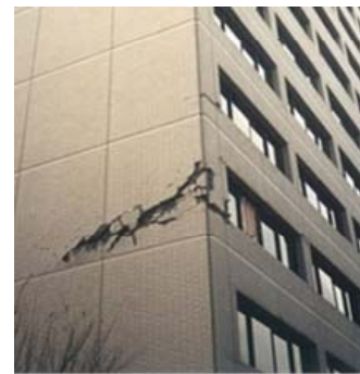
耐震性の不足等
