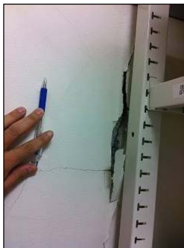
書庫内 : モルタルの剥離有り
