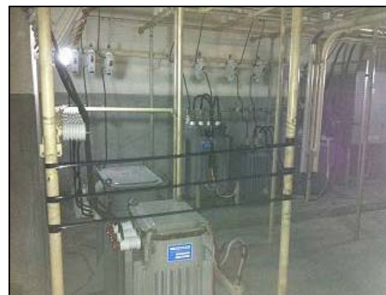
電気室 : 旧式の電気設備であり、老朽化が見られる
