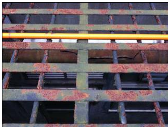
地下ドライエリア内配管 : 配管に亀裂が入っている。
