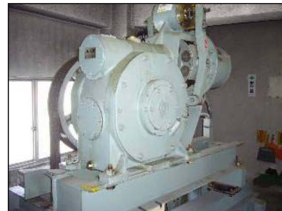
EV機械室 : 機器に経年による劣化が見られる
