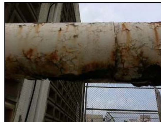
屋上配管類：鋼製配管に劣化が広範囲で見られる
