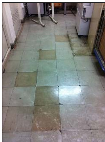
地下廊下：Pタイルの部分的な補修あと有り。
