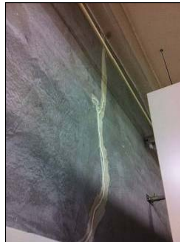
内壁 : 書庫内コンクリート壁にクラック補修のあと有り
