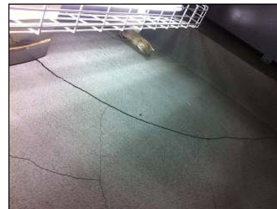
書庫内 : ダクト開口部分から柱へ向けて大きなクラック有り
