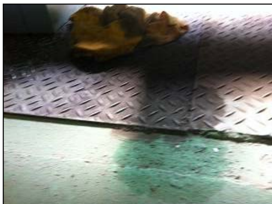
EV機械下 : オイルと思われるものが漏れたあと有り。
