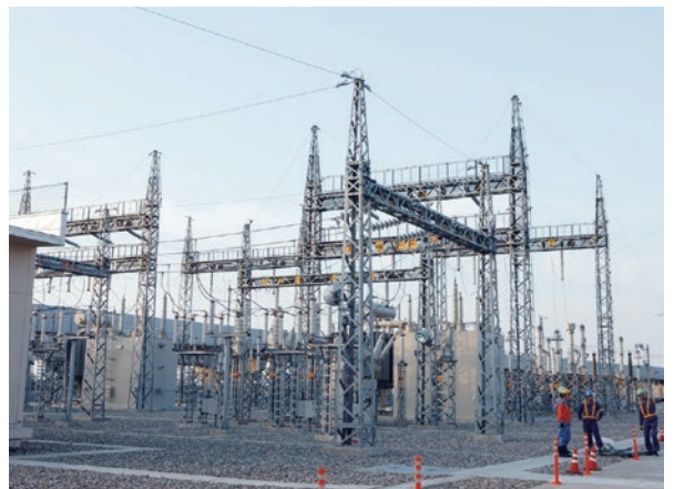
検査が実施された新白山変電所
