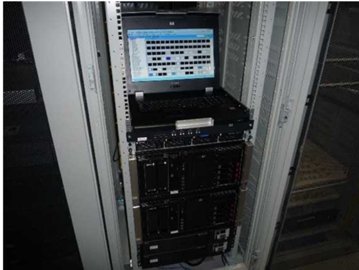
写真-1 監視サーバー本体
