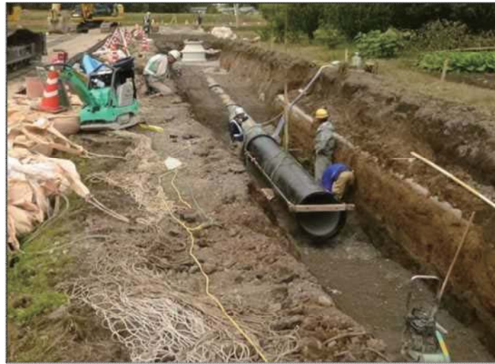
写真-5 ダクタイル鋳鉄管布設状況 【深萱工区改築工事（老朽化対策）】
