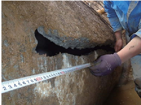
③既設PC管破損状況
