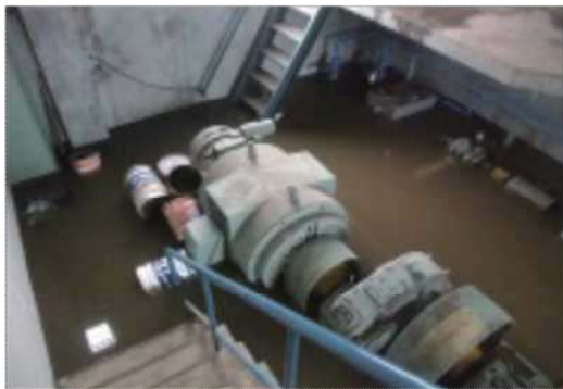
③臼井第二機場ポンプ室内の湛水状況
