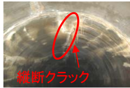
トンネル覆工コンクリートの 縦断クラック
