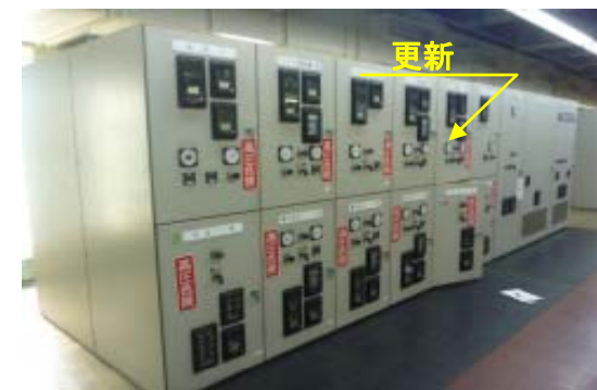
大網揚水機場ポンプ速度制御装置
