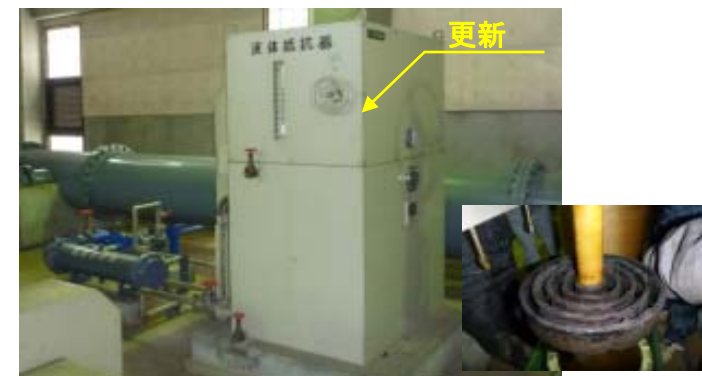
長柄揚水機場ポンプ速度制御装置（液体抵抗器）
