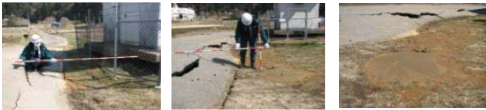
サイホン上部の沈下状況
