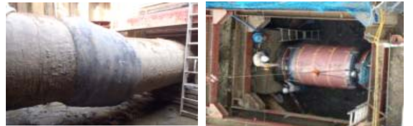
可とう管の変位及び取替状況(成田用水H24.11.30)
