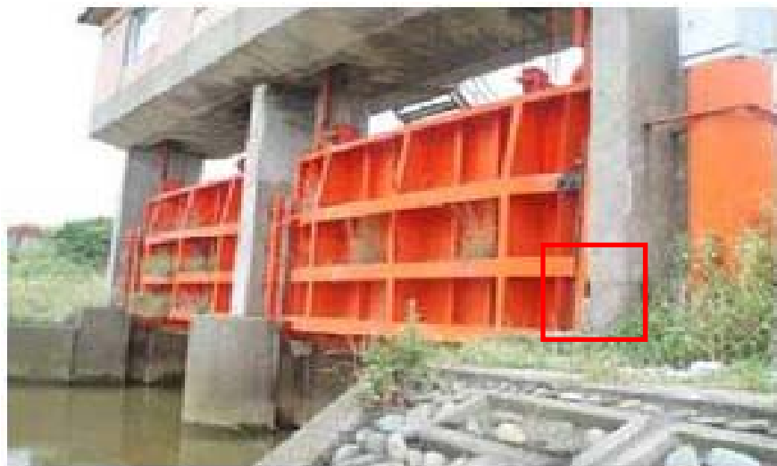
○水門・ゲートの被災事例(新潟県中越沖地震(H19.7.16・震度6強))
