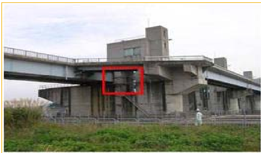
○門柱の被災事例(新潟県中越地震(H16.10.23・震度7))
