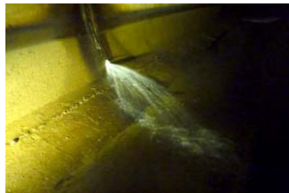
トンネル打ち継ぎ目側壁からの湧水
