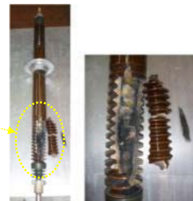
※原因は部材の劣化と考えられる
