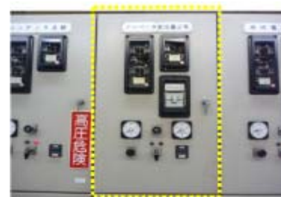
インバータ変圧器2号盤
