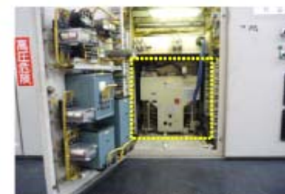
盤内部(他の真空遮断器実装)
