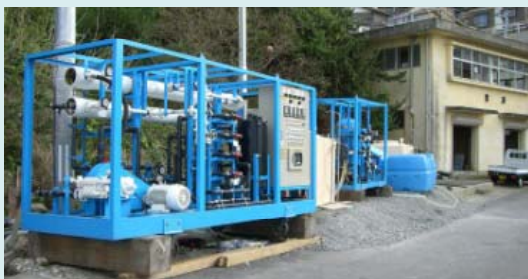
海水淡水化装置設置状況
