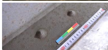
経年耐候性鋼材の発錆状況
