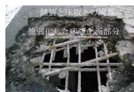
RC 床版の上面脆弱化後の陥没例
