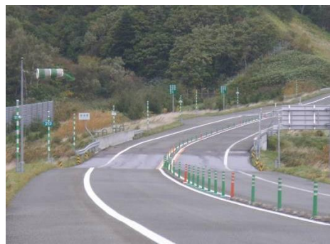
図-14.3 泥炭地盤上の道路の不同沈下
