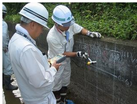
図-14.4 開水路の内部劣化の検出
