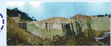
計画規模以上の土石流を受けたが倒壊せず減災効果を発揮した堰堤 (鹿児島県出水市針原地区)
