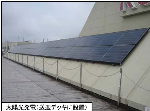
太陽光発電(送迎デッキに設置)
