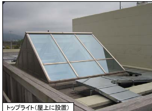
トップライト(屋上に設置)
