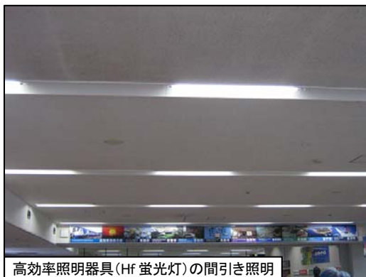
高効率照明器具(Hf 蛍光灯)の間引き照明
