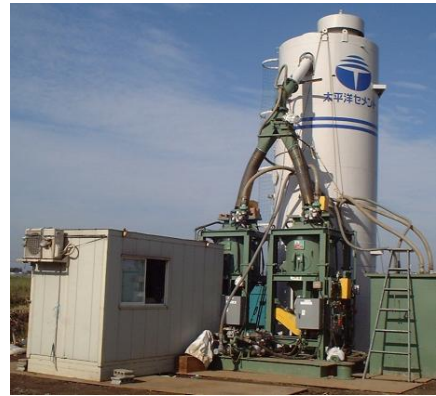
写真-2 改良材プラント
