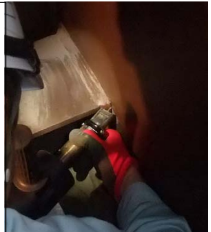
写真一 1 鋼橋での UIT 施工例
