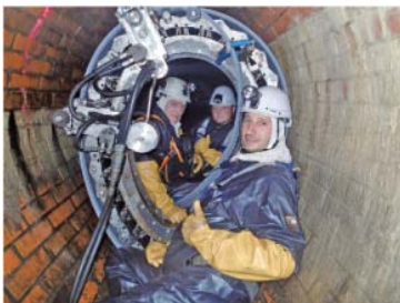
日本の下水道技術(管路更生工法) による欧州都市再生への貢献 (積水化学工業株式会社)
