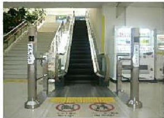
■エスカレーターの自動運転（旅客ビル）
