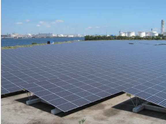
図表2-6-22 扇島太陽光発電所
