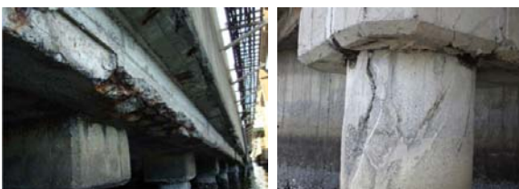
鉄筋コンクリート桁における 主要な鉄筋の腐食 橋脚部における コンクリートのひび割れ
