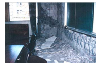
内部の被災状況
