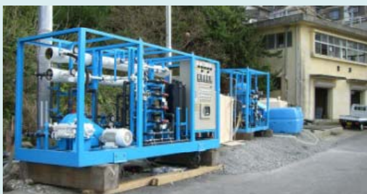
海水淡水化装置設置状況
