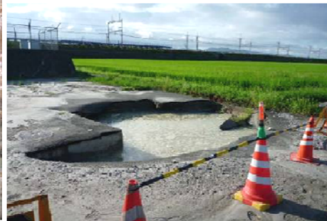
漏水による排泥工周辺陥没状況
