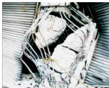
店舗1階柱の圧壊
