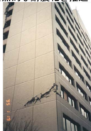
外部の被災状況
