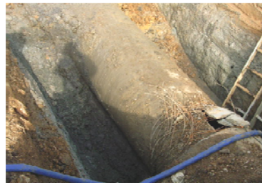
漏水箇所の状況
