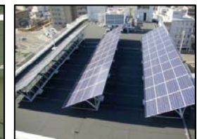
太陽光発電 〈徳島第一合同庁舎〉
