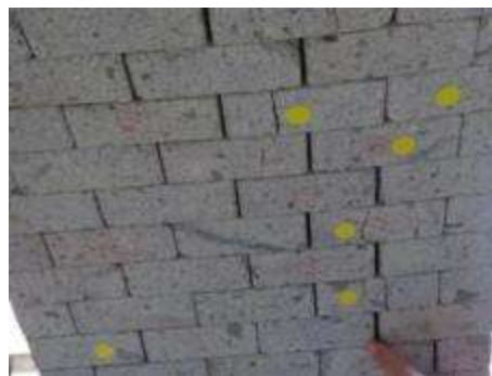
【写真3-16 アーチ輪石の損傷状況(黄色)】
