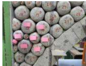
(l) 壁石の孕み状況 2
