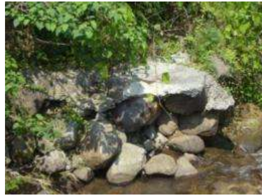
【写真 1-4 基礎部分の洗堀】
