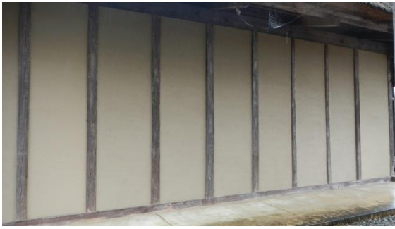
修理後1年経過した民家の真壁
