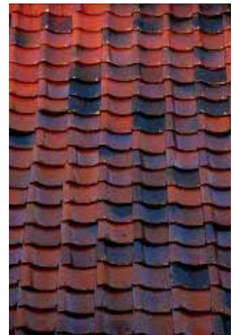
写真1 古瓦で葺かれた屋根
