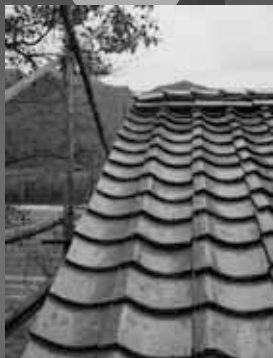
改修前の郷蔵 屋根瓦の状況
