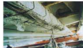
塩害によるコンクリート構造物の劣化事例
