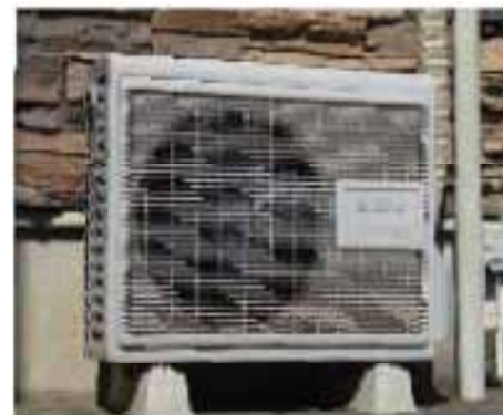
空気熱源ヒートポンプ
