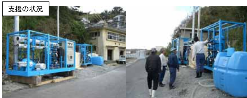
海水淡水化装置設置状況
