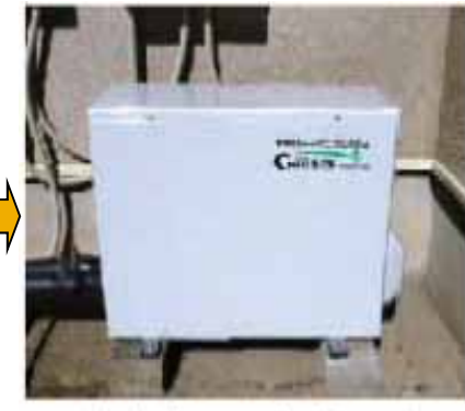
地下水熱ヒートポンプ
