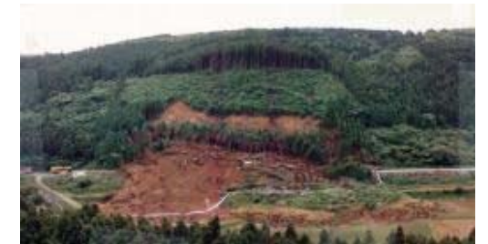
▲並行する現道 【法面崩壊箇所】
