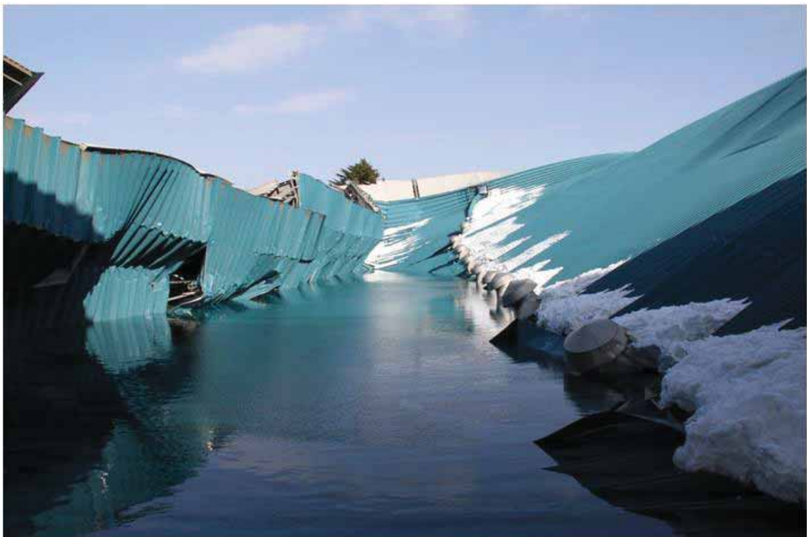
崩落した屋根（中央は実験用水槽）
