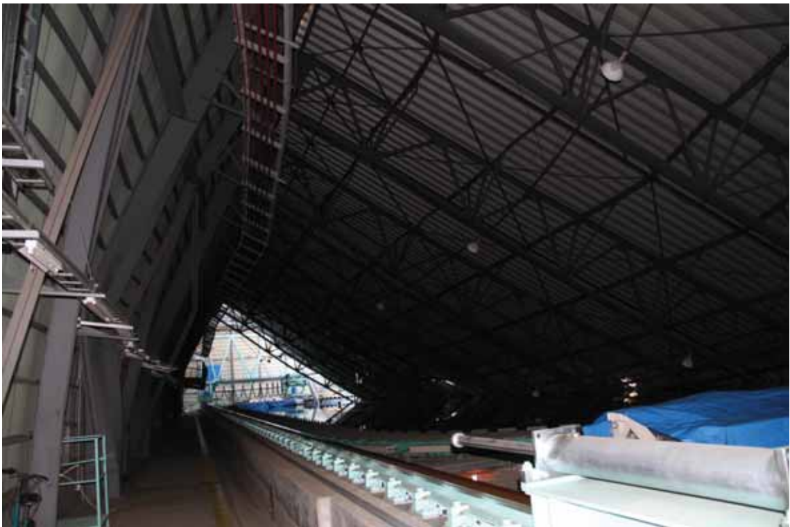
崩落した屋根（南側）
