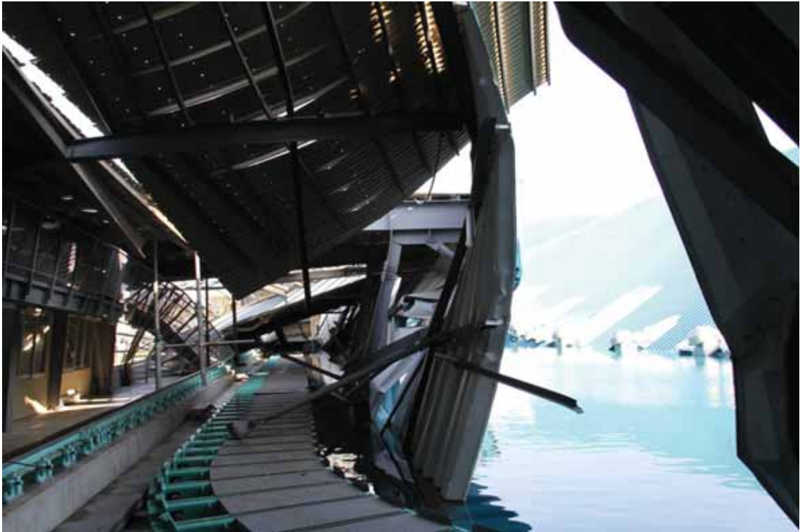
崩落した屋根（北側）
