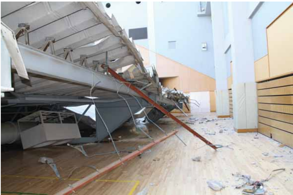
落下した屋根の梁端側
