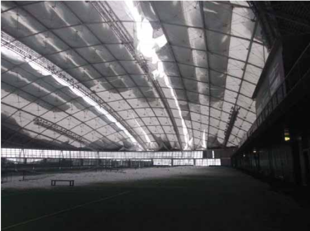
膜屋根の破損状況（2月15日午前8時頃）
