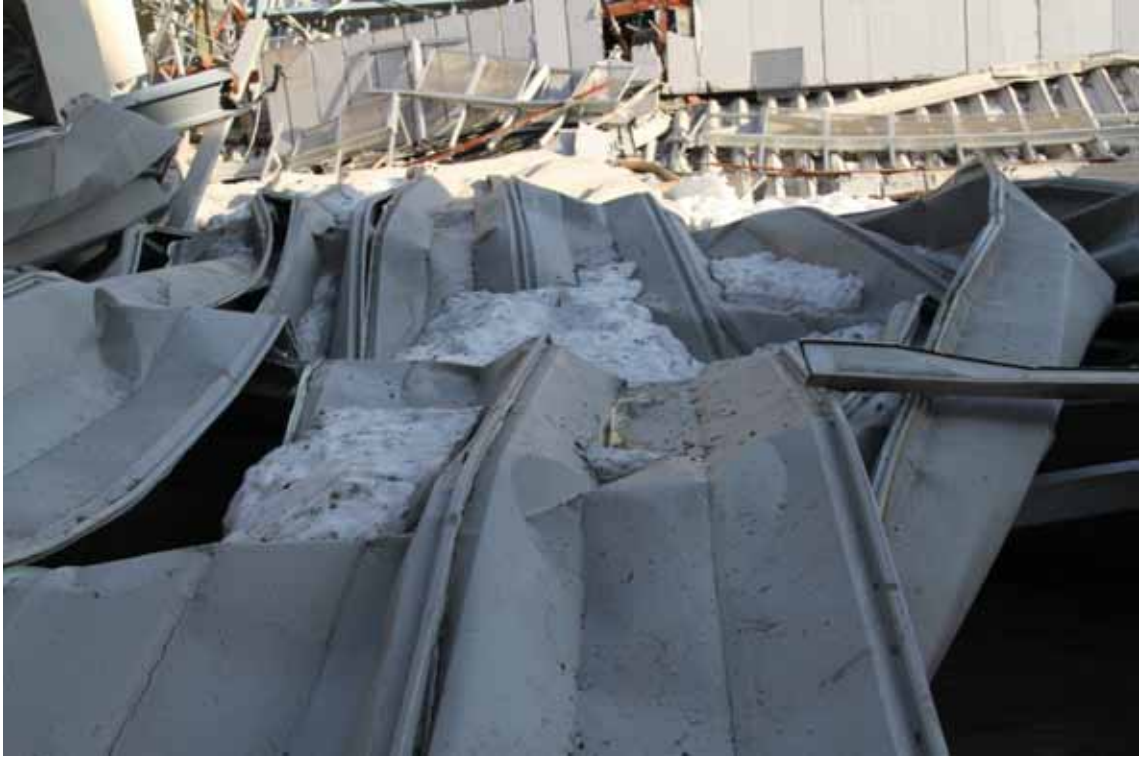
落下した折板屋根
