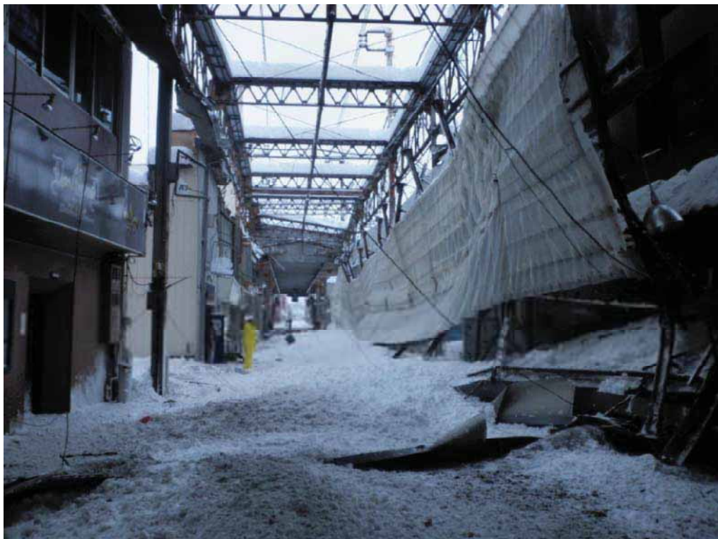
① 高崎中央銀座商店街アーケード（群馬県高崎市）の被害状況
