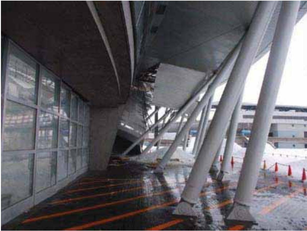
南側軒天井破損狀況
