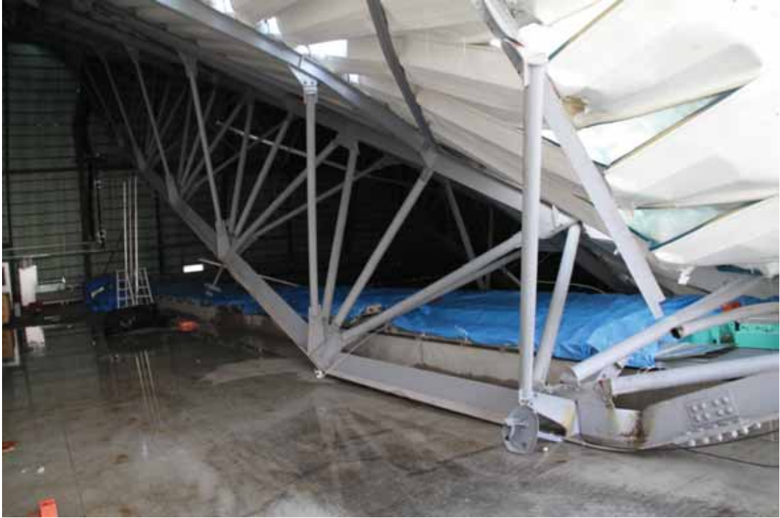
崩落した屋根（東側トラス梁）
