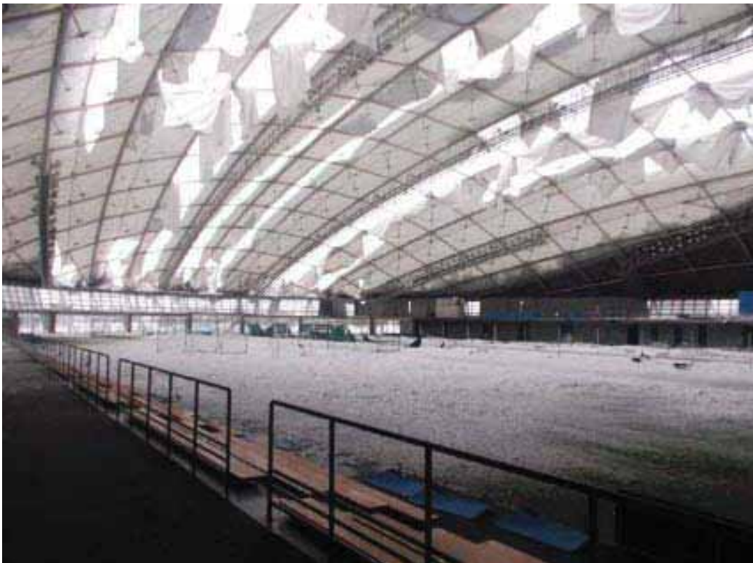
膜屋根の破損状況（2月15日午前11時頃）
