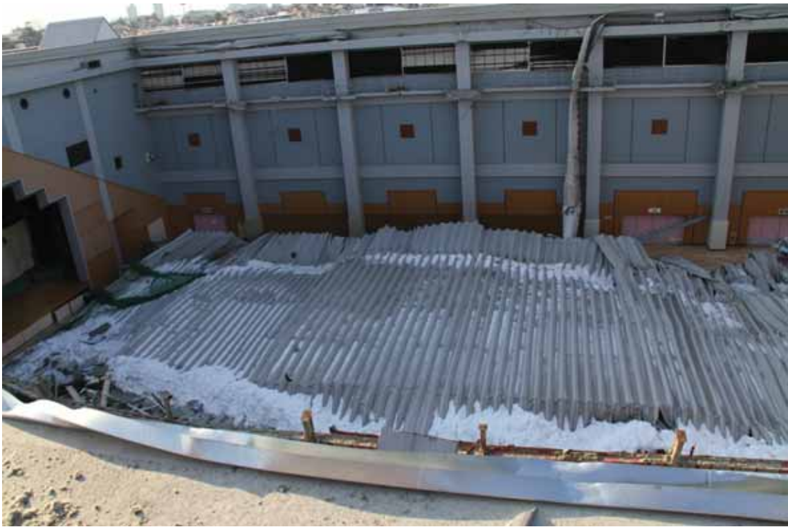
落下した屋根の全景
