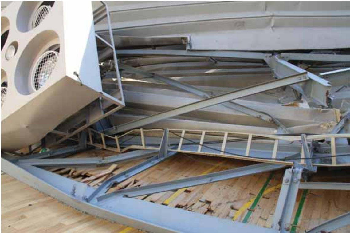
落下した鉄骨トラス
