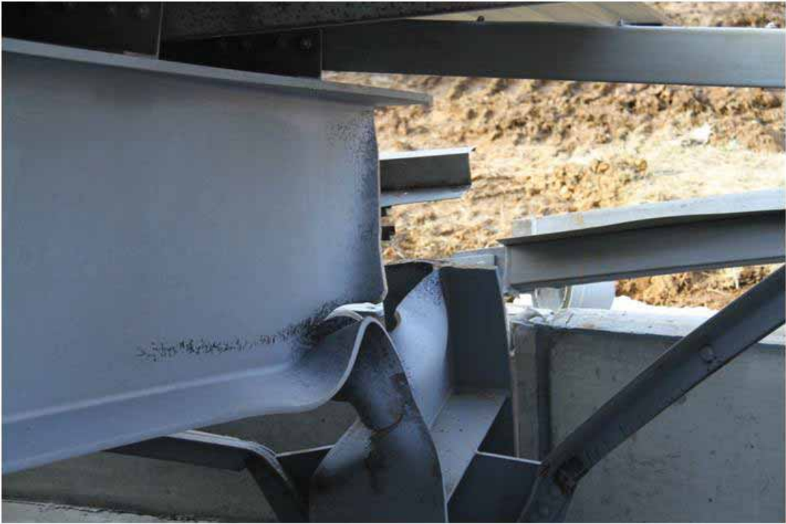
破断した柱（北側壁）
