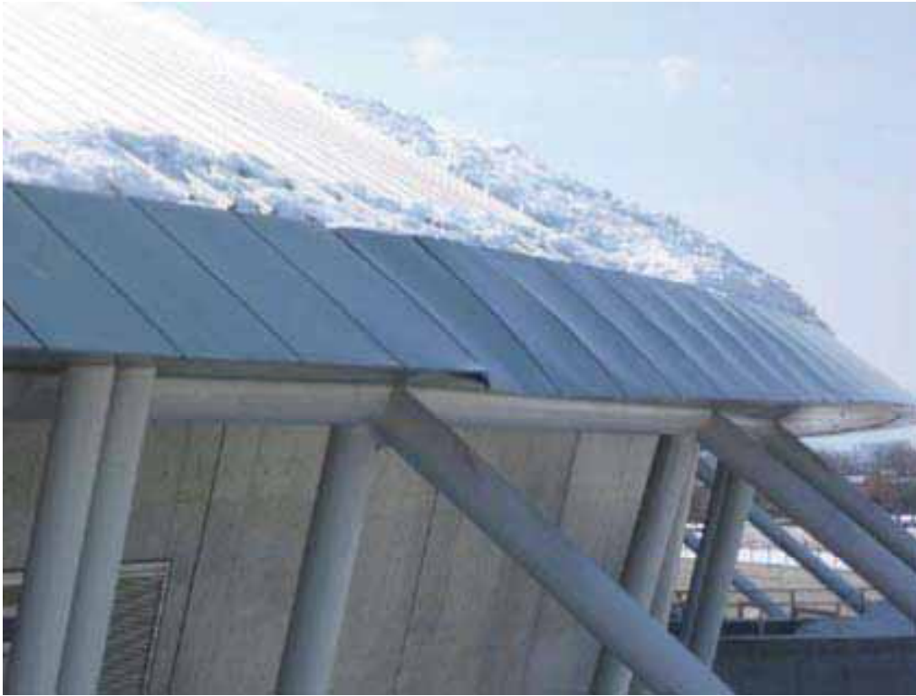
外周パネル破損状況
