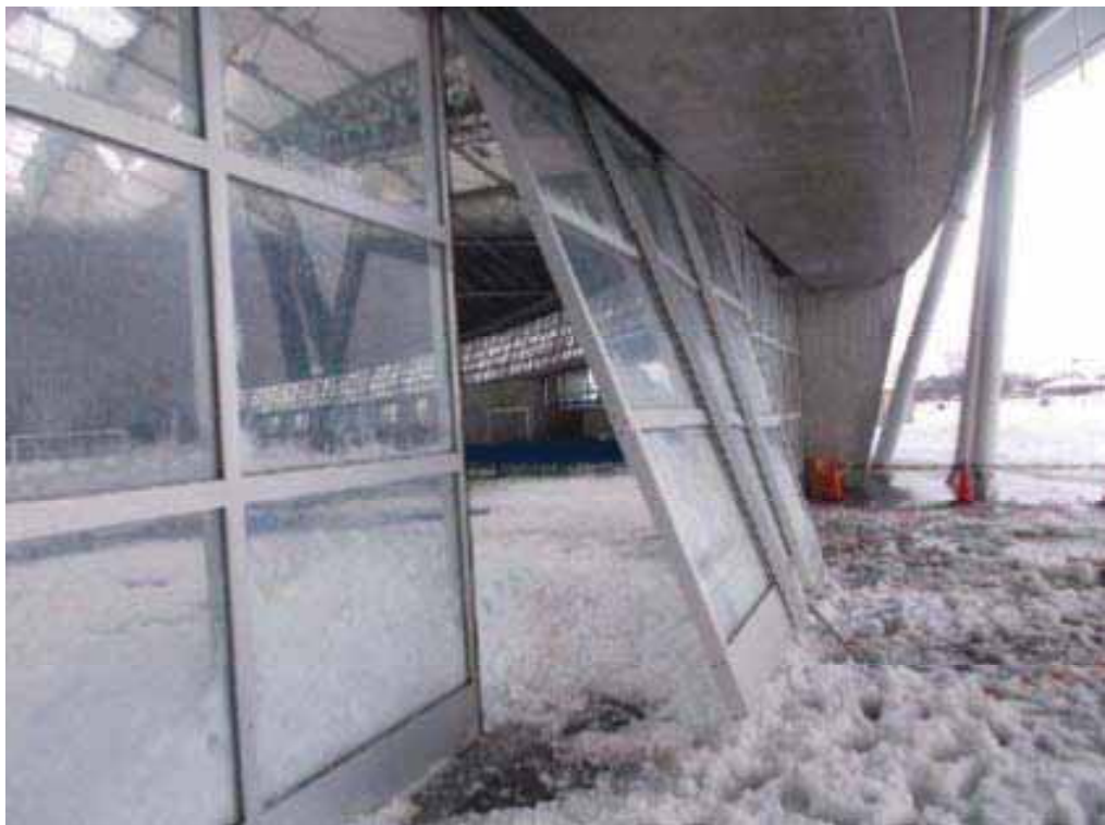
南大扉破損狀況
