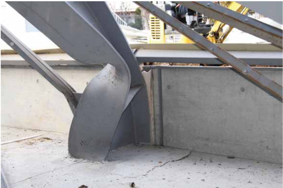
曲げ降伏した鉄骨柱（北側壁）
