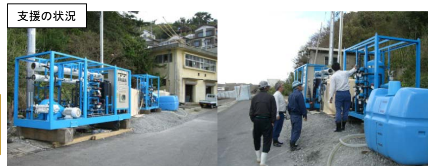
海水淡水化装置設置状況
