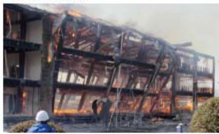
75分：軸組中央部分倒壊
