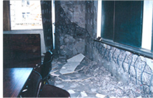
内部の被災状況
