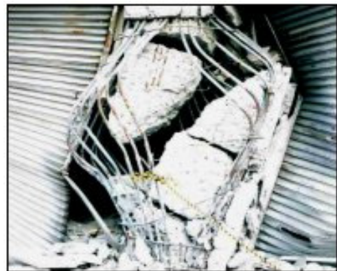
店舗1階柱の圧壊
