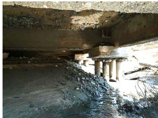
建物基礎が露出
