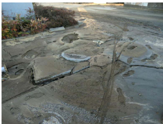
庁舎が液状化被害を受け、 外構の地盤全体が沈下。
