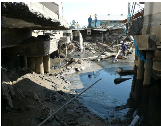
庁舎周囲の地盤流出
