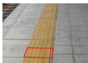
内方線付き点状ブロック
