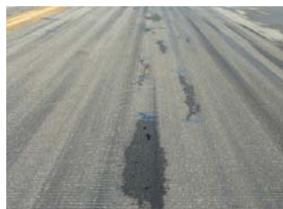
(老朽化した基本施設舗装)
