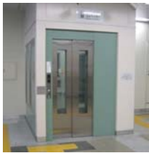
エレベーター
