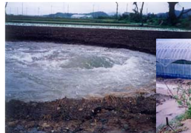
伊良湖サイホン漏水状況
