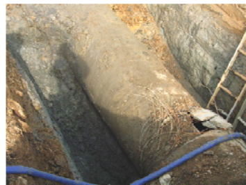
漏水箇所の状況
