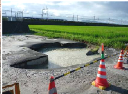
漏水による排泥工周辺陥没状況
