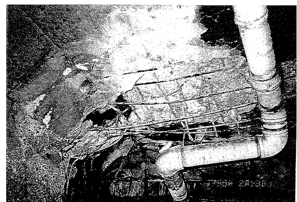
天井スラブのコンクリート剥落 (三宮駐車場公園下 B2 階)
