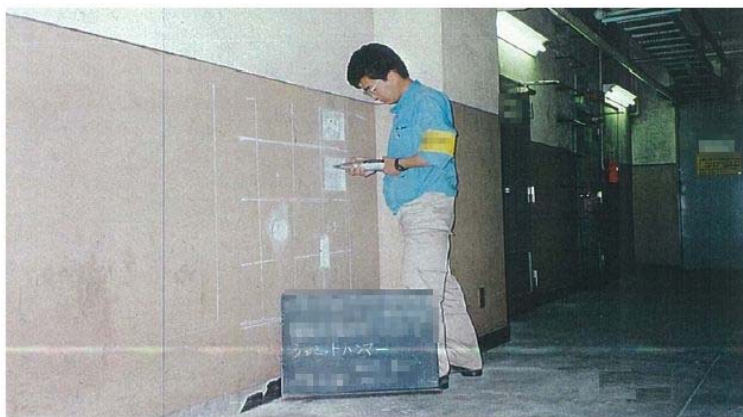
写真 3-2-6 リバウンドハンマーによるコンクリート強度推定状況
