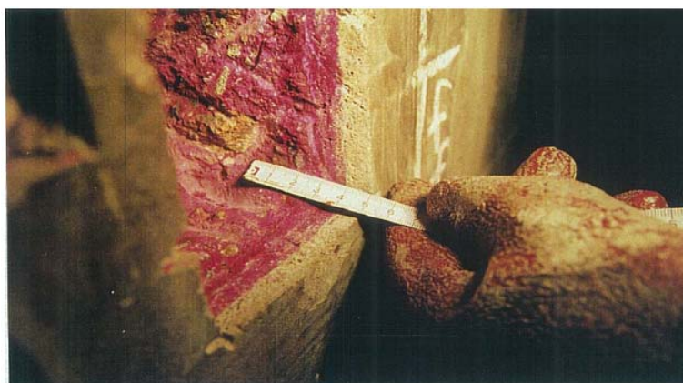
写真 3-2-7 フェノールフタレイン試薬による中性化試験（赤く染まった部分がアルカリ性）
