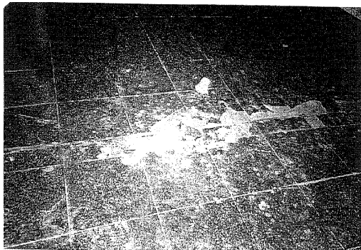
写真 2-1-1 (b) JR 三宮駅への連絡通路床の被害 (阪神電車の線上)
