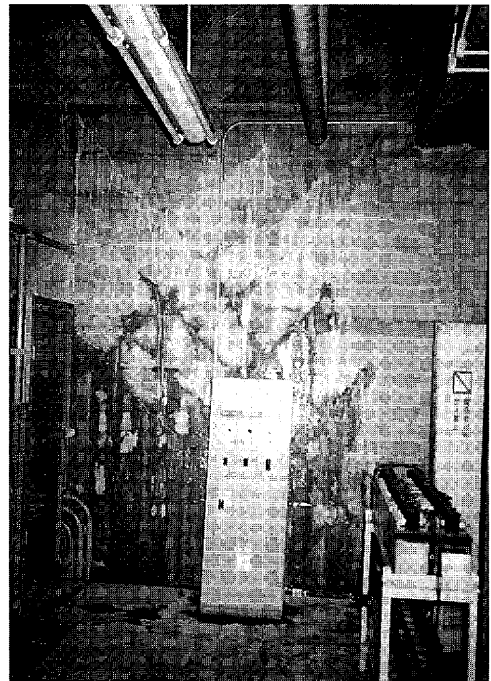
写真2-1-4 電気室の壁のひび割れ状況 (Bゾーン)
