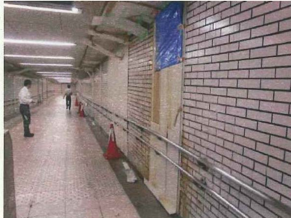
南北線の勾当台駅地下通路の漏水状況
