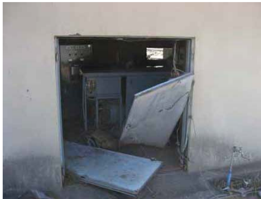
津波による建具破損状況(岩手県大槌町浪坂ポンプ場)
