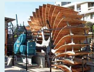
家中川小水力市民発電所 (最大出力20kW)
