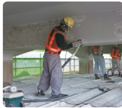
足場が組まれた高架橋下。中性化抑止のための表面保護工の工事中。
