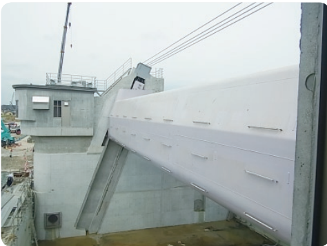
旧ゲート（ローリングゲート）の溝を利用して、剛性が高いシェル構造ローラゲートへ更新。
