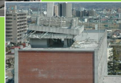
倒壊した郡山市役所屋上
