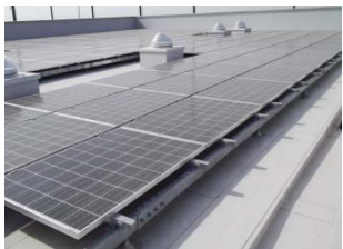
<太陽光発電設備>
